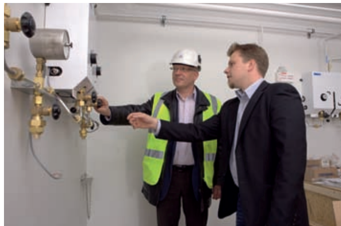
Harri Apell (till vänster) och Pekka Teirikari i den fem före färdiga gascentralen på Barnkliniken.
